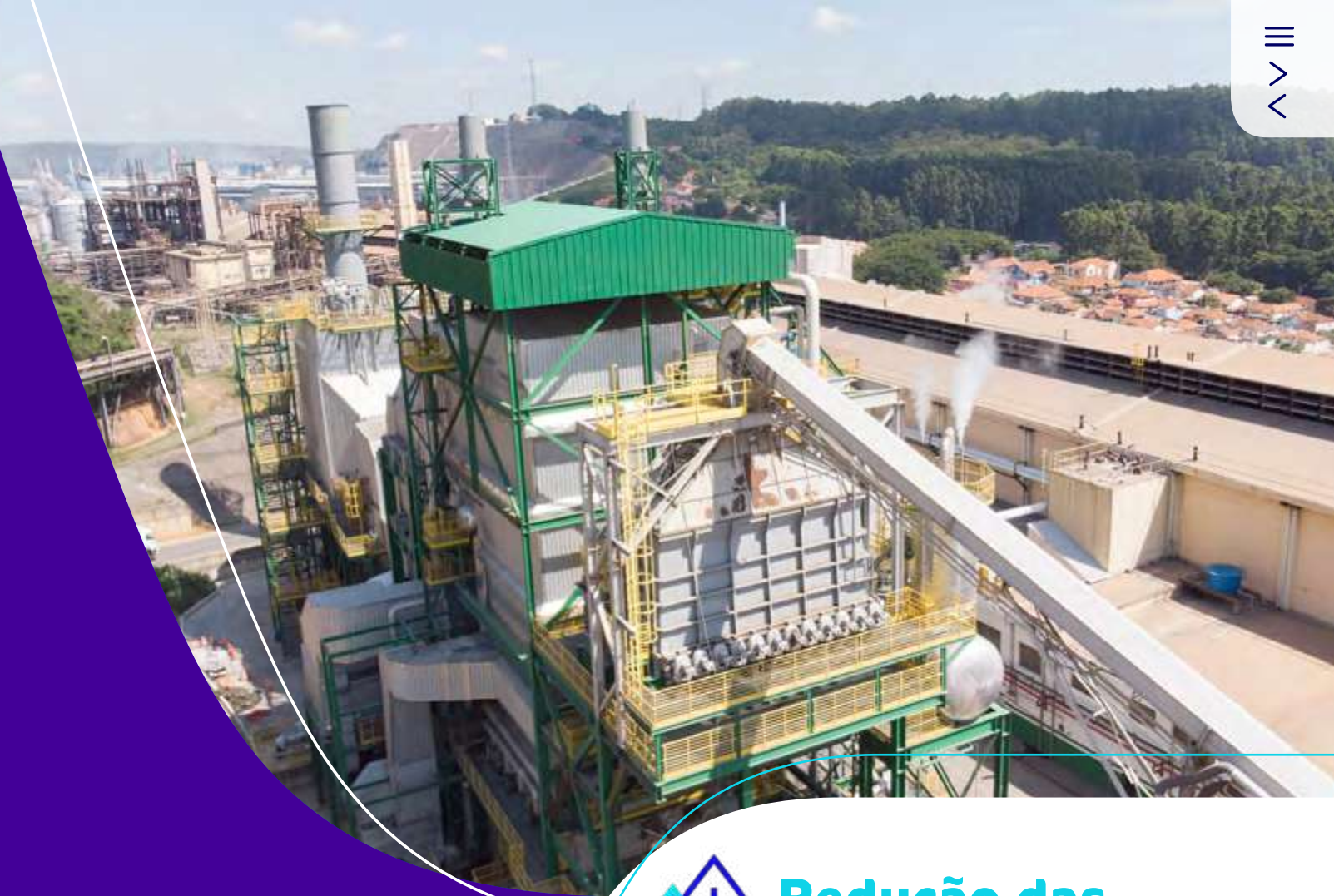
Caldeira à biomassa, Refinaria da Fábrica de Alumínio (SP)
